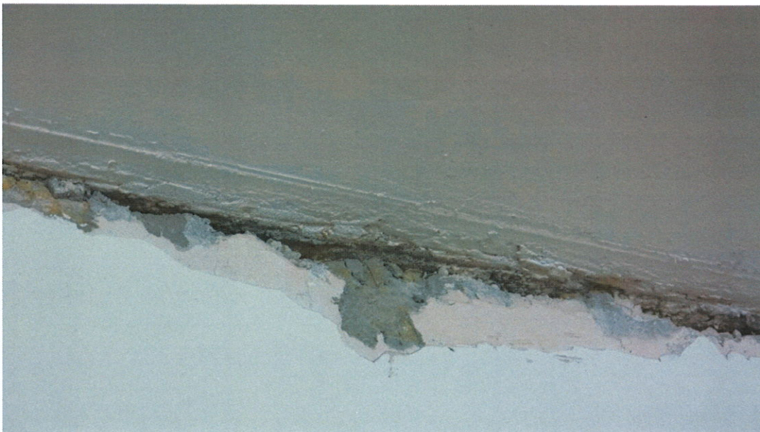
Obr. 3 Trhlina a odpadnutí omítky s kusy betonu ve třetině délky průvlaku
