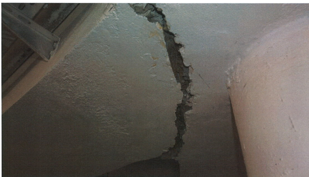
Obr. 6 Trhlina v dilatační spáře mezi kolmo navazujícím průvlakem a podélným průvlakem
