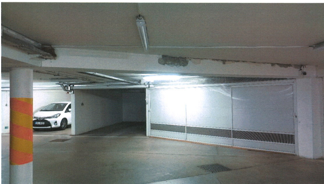
Obr. 1 Celkový pohled na oblast poruchy (srpen 2023)
