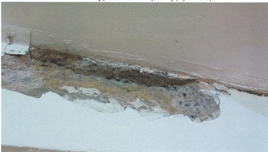
Obr. 2 Trhlina a odpadnutí omítky s kusy betonu uprostřed délky průvlaku
