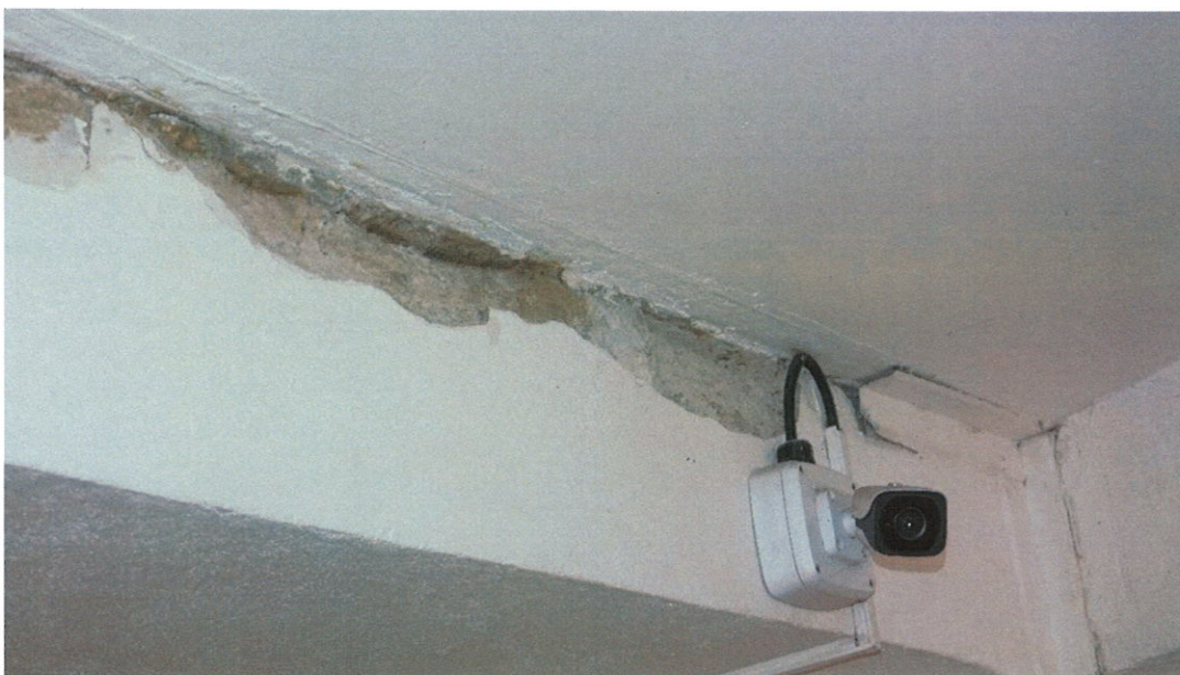
Obr. 4 Trhlina a odpadnutí omítky s kusy betonu v blízkosti uložení průvlaku
