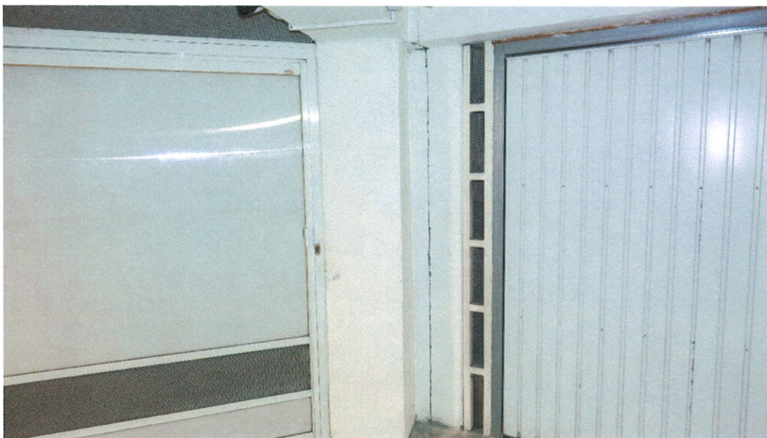
Obr. 5 Projev dilatačních pohybů podél sloupu pod průvlakem
